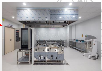
EQUIPAMIENTO DE COCINA
